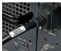
Étiquetage des infrastructures électriques
