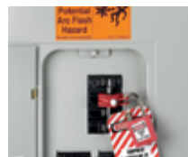
Signalisation de sécurité
