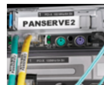
Étiquetage des infrastructures réseau
