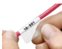
Étiquetage de fils et câbles
