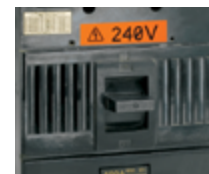
Étiquettes de danger électrique
